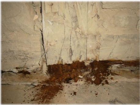
Der verfaulte untere Querbalken
